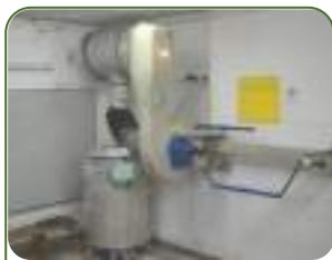
Іл. 39.5. Фільтровентиляційний агрегат
